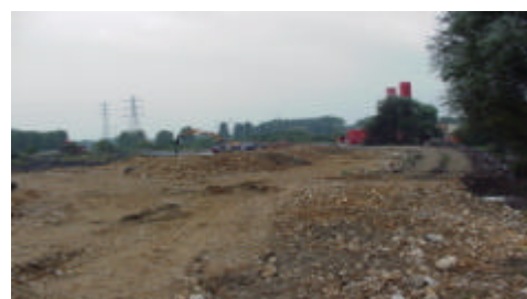
Lagune après traitement
