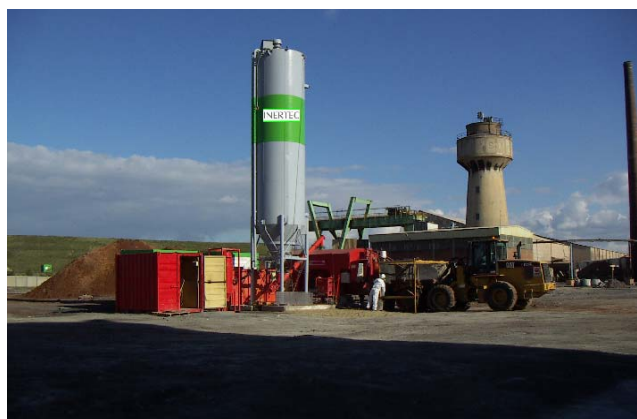
Unité mobile de traitement des résidus
